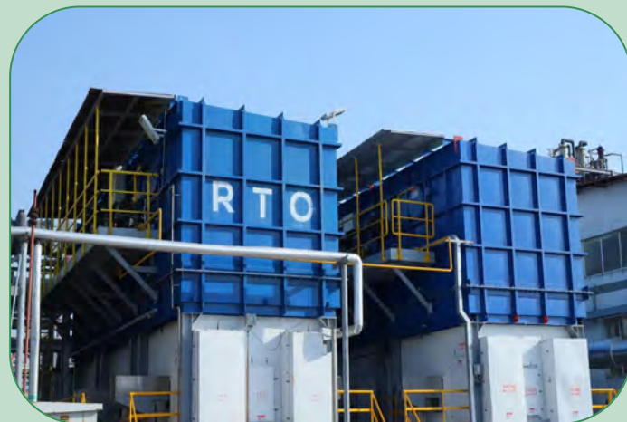
潍坊东厂区RTO废气焚烧装置
