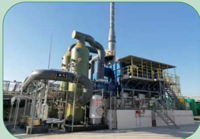
潍坊西厂区RTO废气焚烧装置
