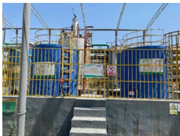
宁夏南厂区罐区
