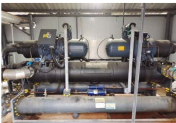
冷却水闭环装置
