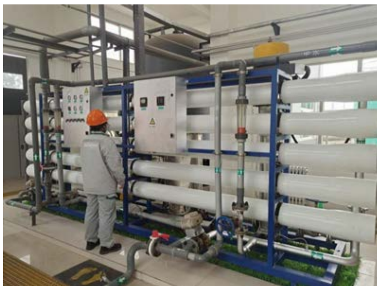
潍坊西厂区中水回用装置
